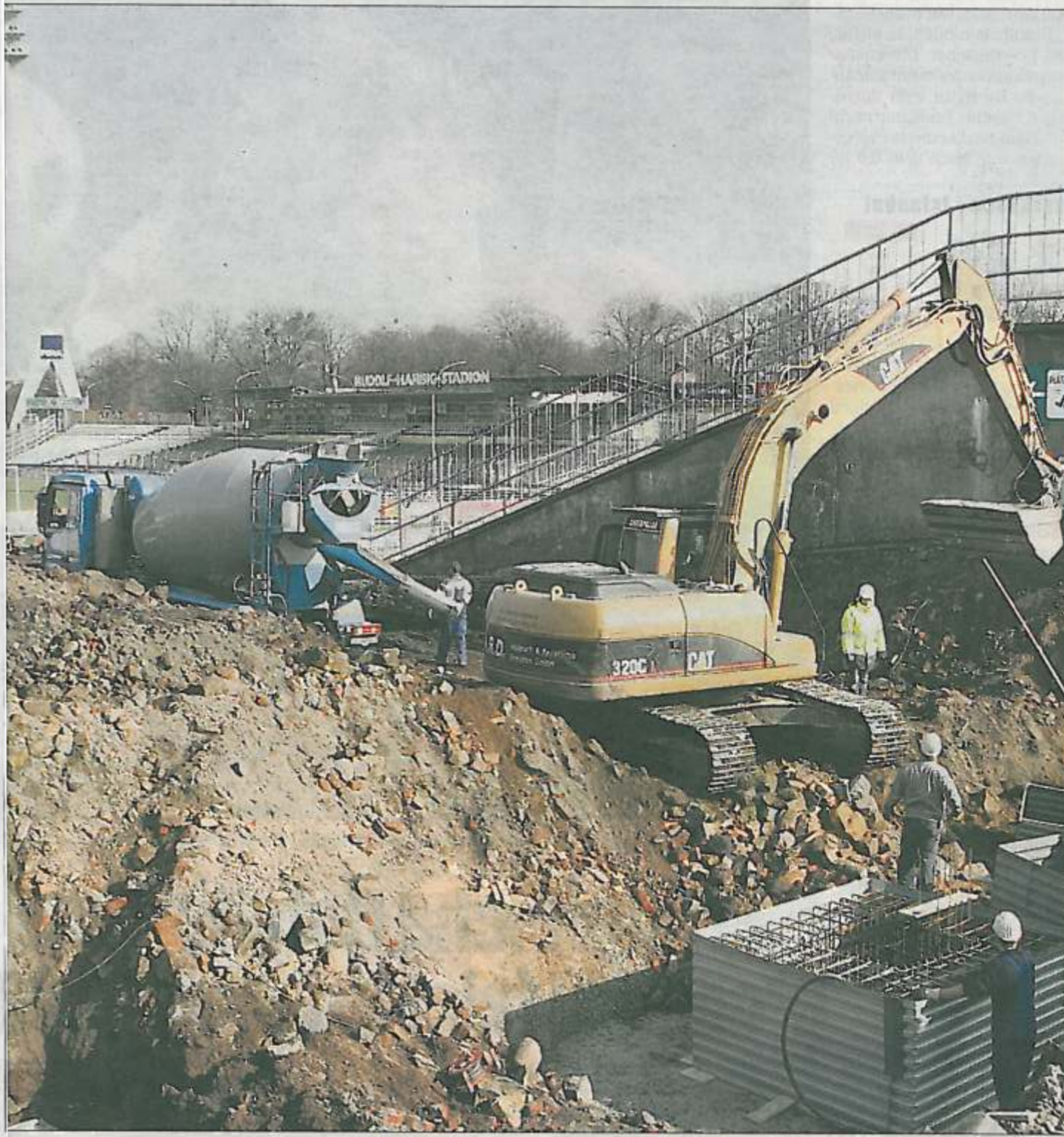
Im Harbig-Stadion wird kräftig gebaggert - vom alten Oval ist nur noch die Hälfte da. Trotz der Umstände soll das „Sicherheitsspiel“ gegen Magdeburg eine gelungene Bewährungsprobe für Dynamo werden.
